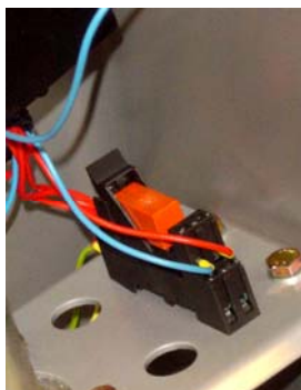
Termosikringen er udløst
