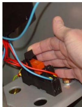
Termosikringen på plads
