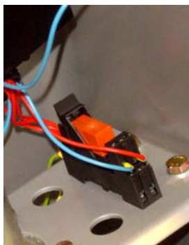
Termosikringen er udløst
